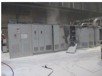
Armoires électriques du variateur R3
