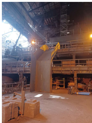
Mise en place d'un toboggan entre le plancher des tuyères et le plancher de coulée
