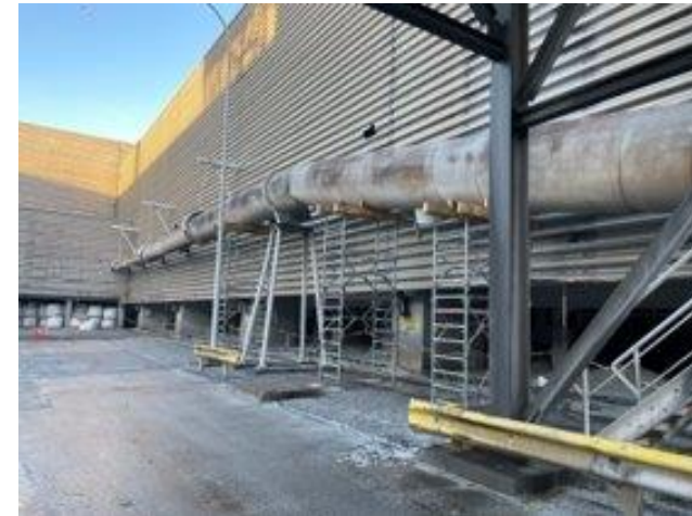
Collecteur de Gaz Coté Est (GT6) sécurisé
