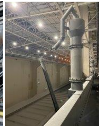
TPHD – alimentation des cuves en alumine avec son dégazage cassé
