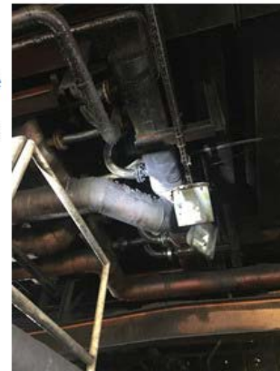
Plafond du 3eme étage, sous les flexibles inox
